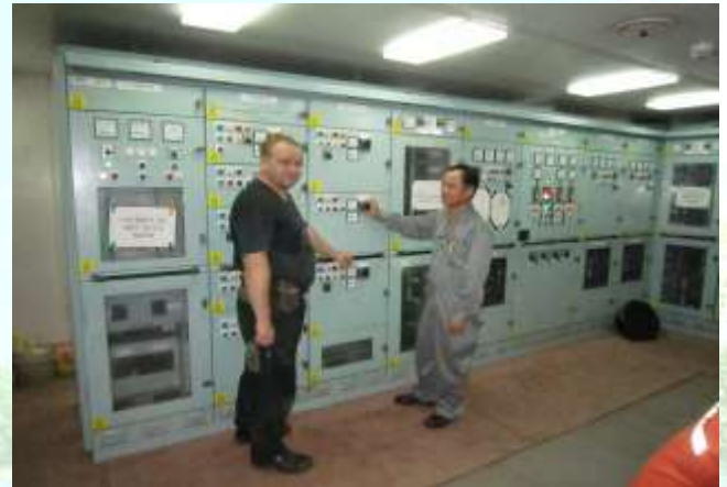
Thầy Bùi Văn Dũng cùng chuyên gia nước ngoài kiểm tra kỹ thuật tại buồng điều khiển tàu 53.000T tại Nhà máy đóng tàu Hạ Long
